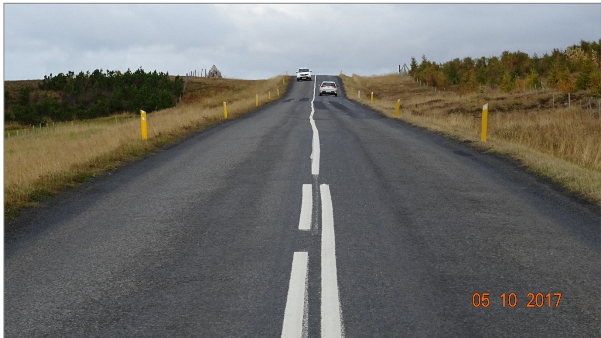
Mynd 6. Blindhæð á núverandi Skagastrandarvegi. Á blindhæðinni má sjá príflur yfir girðingar beggja vegna vegarins. (ljósmynd: SJ).
